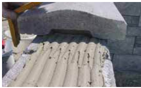
4. Dichtschlämme/ Abdeckplattenkleber mit Glättkelle mit runder Zahnung kommt es zu vollflächiger Verklebung
